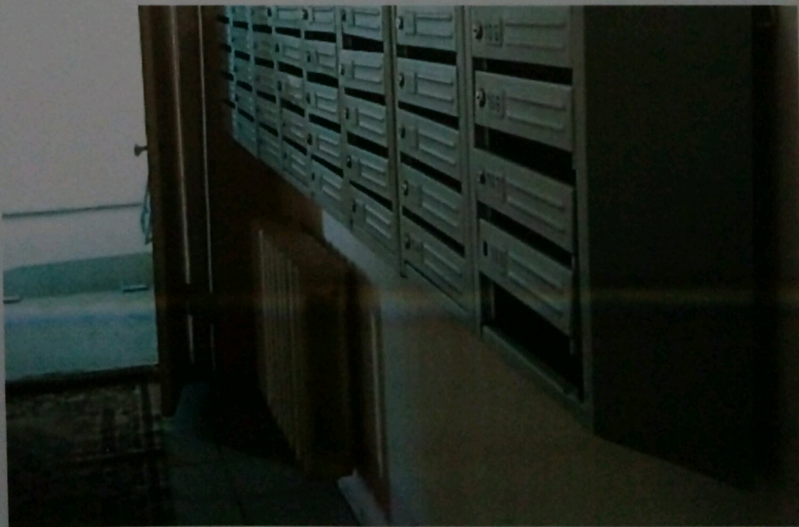
Фото 26. Отсутствует створка почтового ящика 4-го подъезда.
