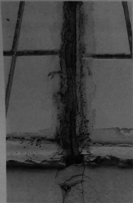
Фото 7. Разрушение межпанельного шва
