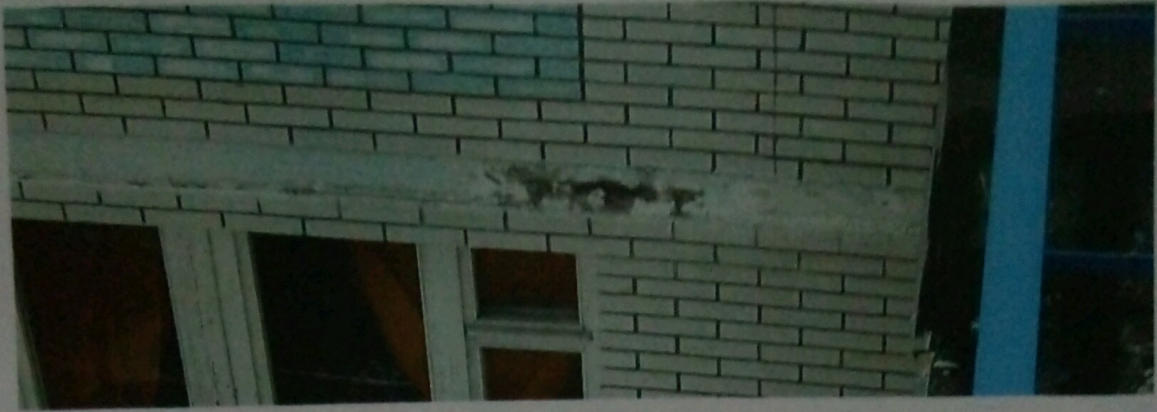
Фото 10. Разрушение защитного слоя торца плиты перекрытия
