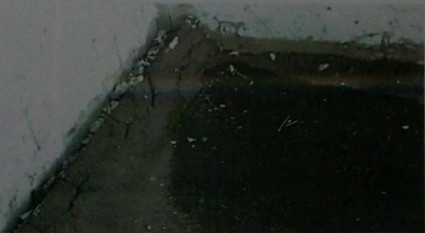
Фото 22. Провалы отмостки. Зазор между зданием и отмосткой.
