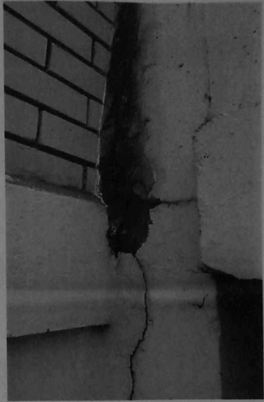
Фото 8. Разрушение деформационного шва
