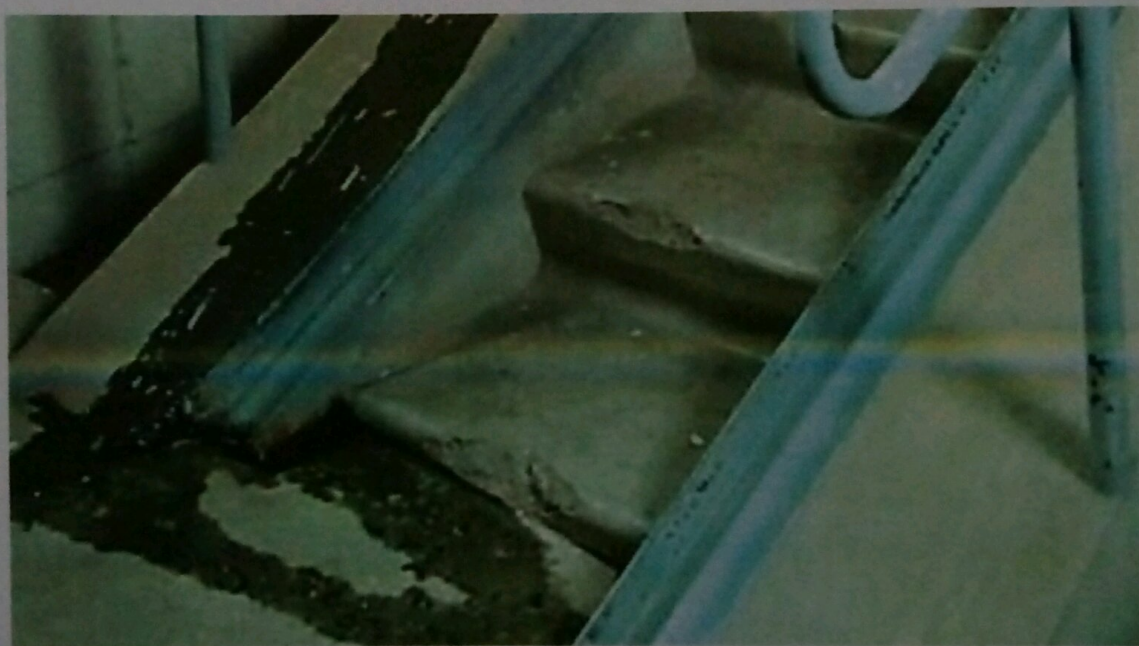
Фото 14. Разрушение ступеней лестницы подвезда.
