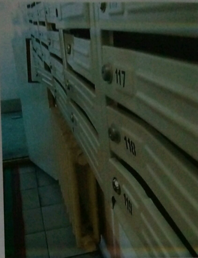
Фото 25. Деформации дверок почтовых ящиков в подъезде 3-й секции.
