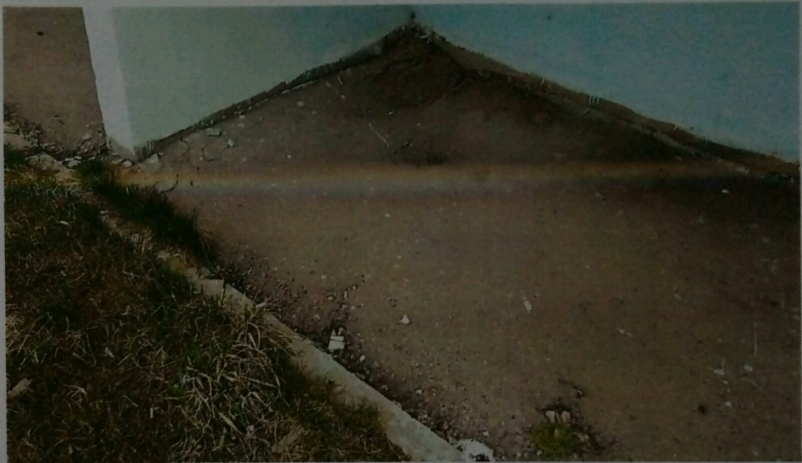
Фото 21. Провалы отмостки. Зазор между зданием и отмосткой. Растительность в трещинах отмостки.
