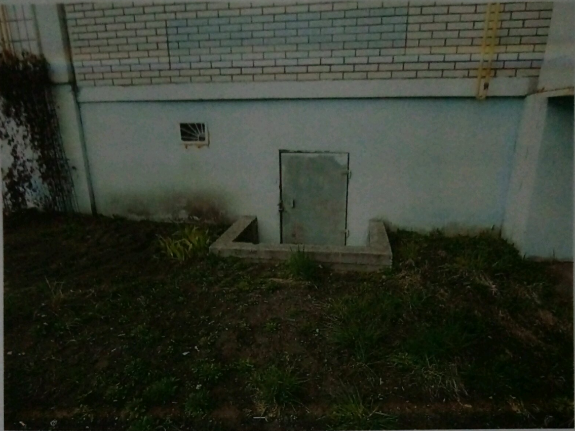
Фото23. Отсутствует часть отмостки 4 секции.
