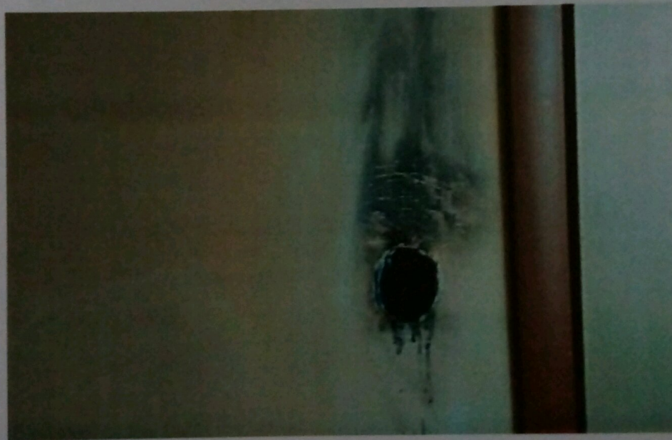
Фото 30. Следы короткого замыкания.
