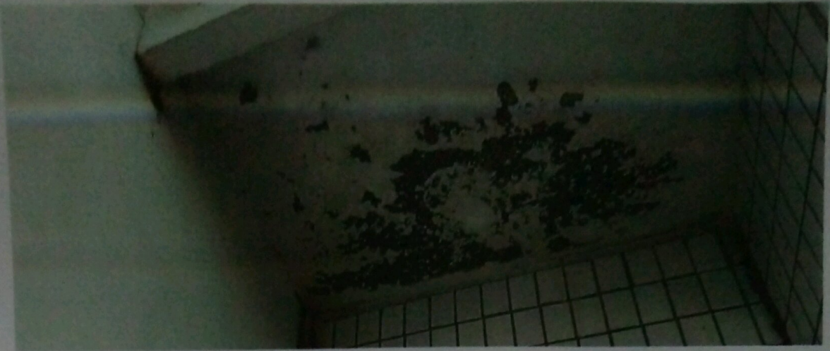
Фото 20. Следы замокания и разрушения отделочного слоя на конструкциях покрытия подъездов.
