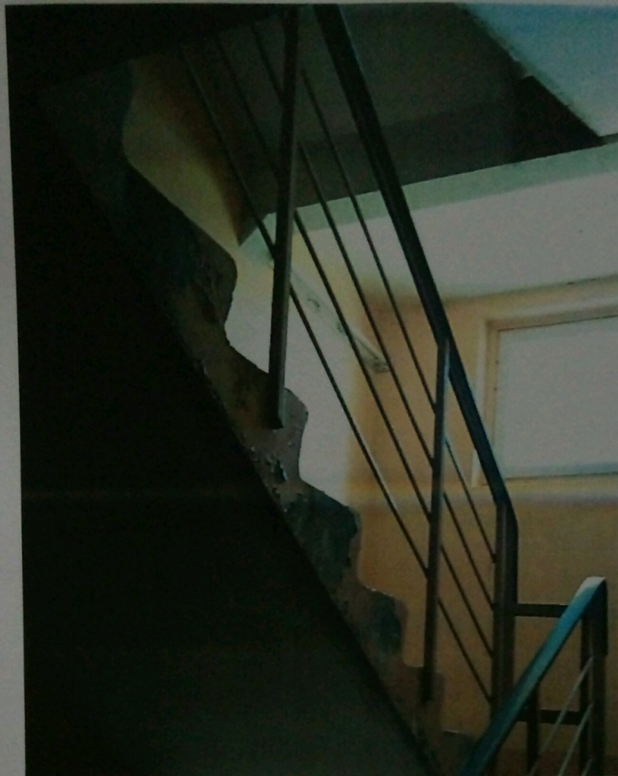
Фото 32. Разрушение окрасочного и отделочного слоев боковых поверхностей лестничных маршей в подъездах.
