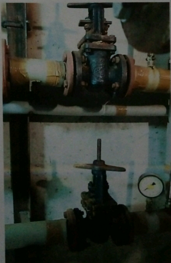
Фото 28. Протечки задвижек ГВС и Отопления.
