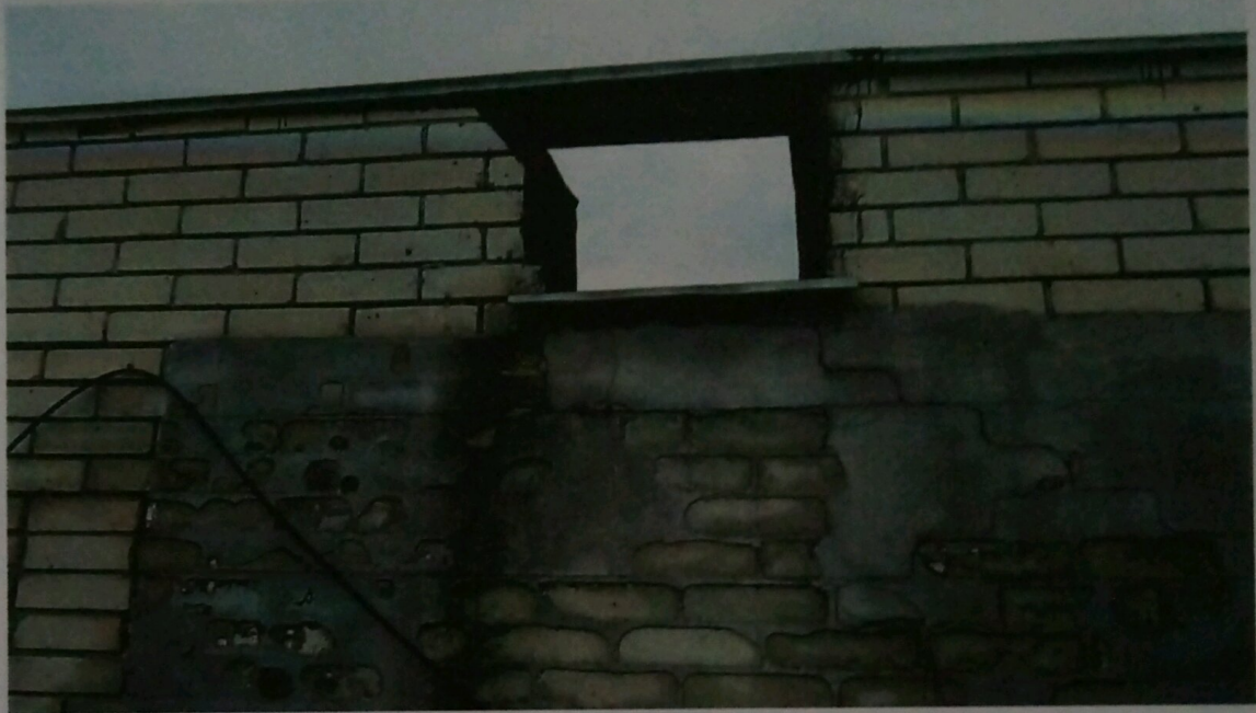
Фото 11. Следы замкания кирпичной кладки стены лифтовой шахты шестой секции. Водоотвод неорганизованный.
