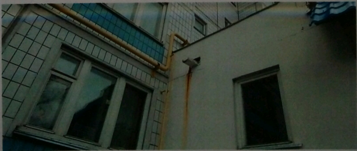
Фото 12. Неорганизованный водоотвод с кровли подъездов.
