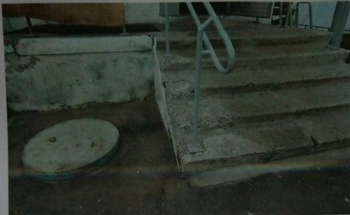
Фото 13. Разрушение ступеней крыльца 3-й секции. Деформации площадок крылец, пандусов и лестничных маршей в следствие осадок основания.
