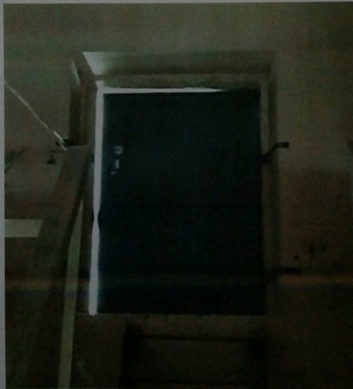
Фото 24. Выход на кровлю. Зазор между коробкой и дверным полотном.
