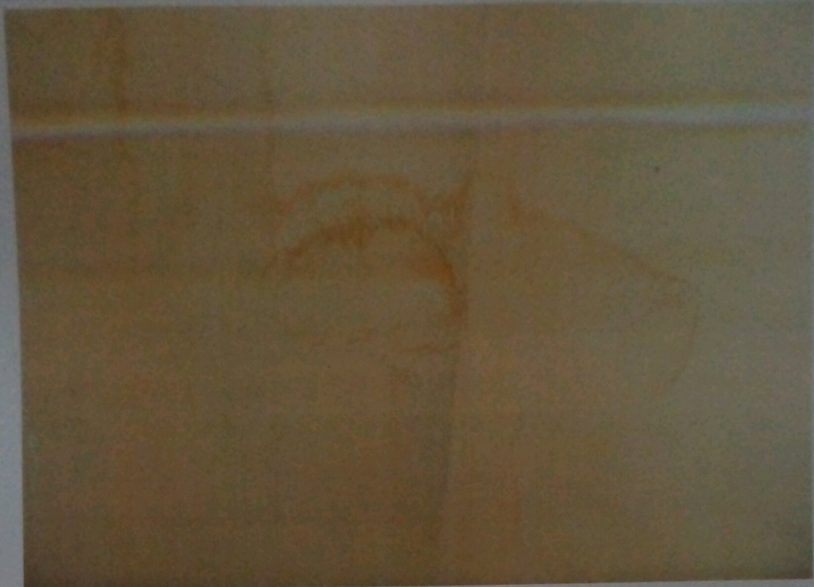
Фото18. Следы замочания стен через межпанельные швы.
