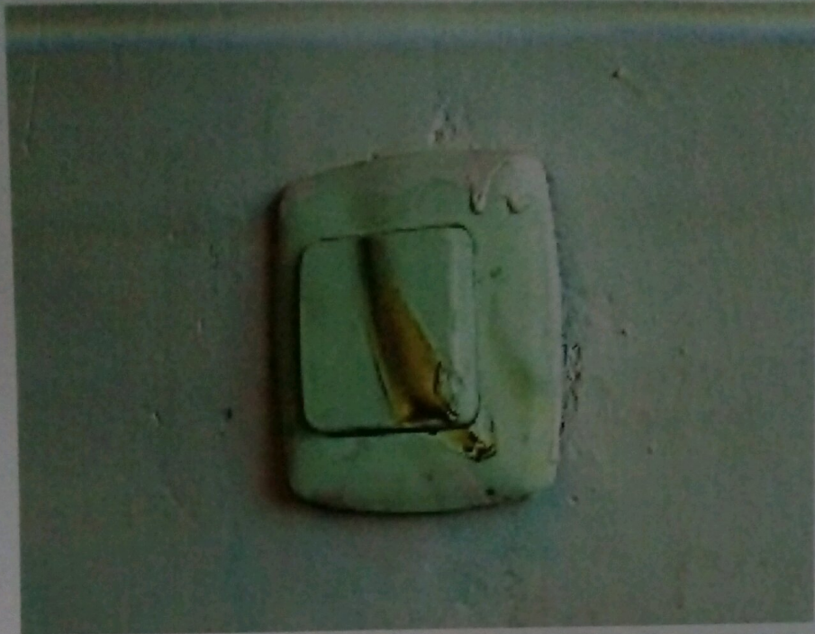
Фото 29 . Следы короткого замыкания на выключателе подъездного освещения.
