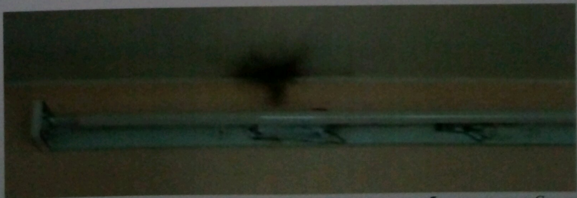
Фото 31. Отсутствует защитный колпак на осветительном приборе подъезда. Следы короткого замыкания.
